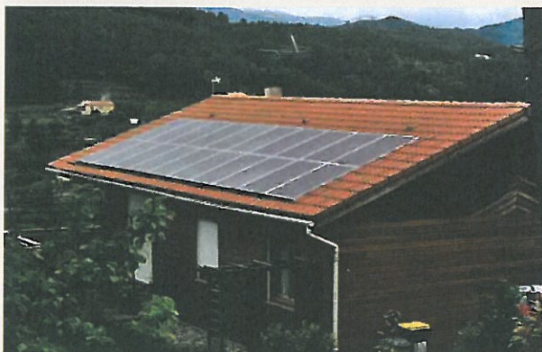
Installation sur maison individuelle
