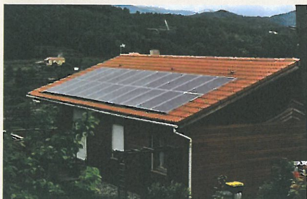
Installation sur maison individuelle
