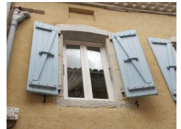
Volets en Z inadaptés aux proportions des hautes fenêtres
