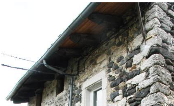
Débords de toit en chevrons de bois dont les extrémités sont taillées en corbeau.
