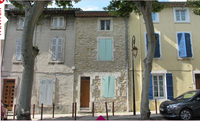
La mise à nu des pierres de la façade du milieu est une erreur technique et historique et ce traitement dénote au sein du front bâti dont les façades sont toutes enduites
