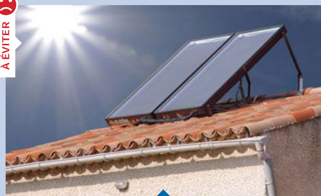
Panneaux rajoutés sur la toiture et non intégrés à la pente du toit
