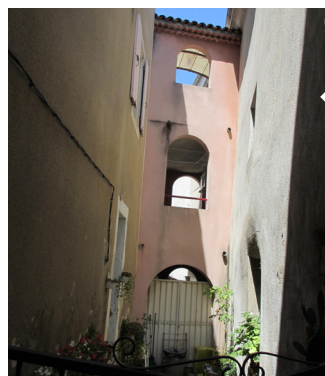
La passage couvert a été obstrué pour un usage privé
