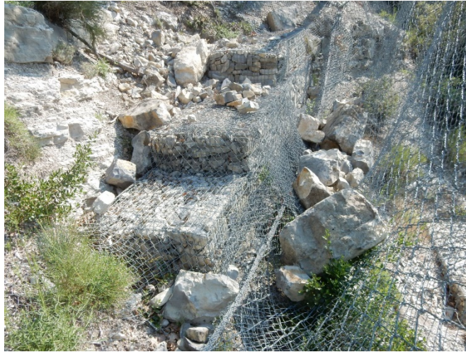
fig.66 : Filet FD4 et seuil gabion SD2 après éboulement
