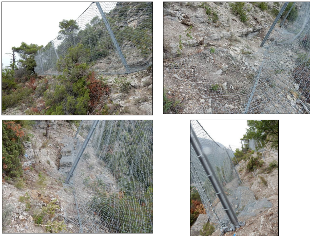
fig. 66 : Filets FD3 et FD4 avec aperçu des gabions SD1 et SD2 avant éboulement
