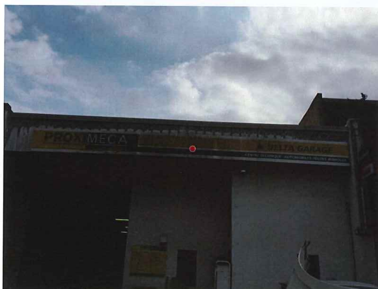
Enseigne parallèle en mauvais état d'entretien, Mouans-Sartoux.
