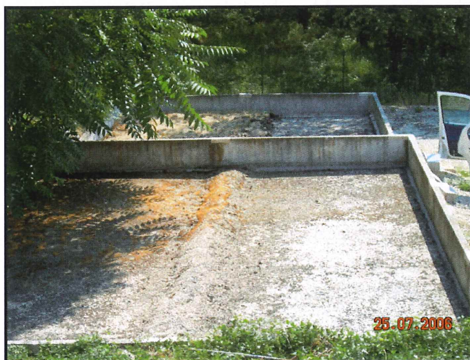
Photo 13 : Lits de séchage des boues
