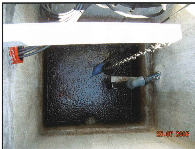
Photo 10 : Poste de relèvement
