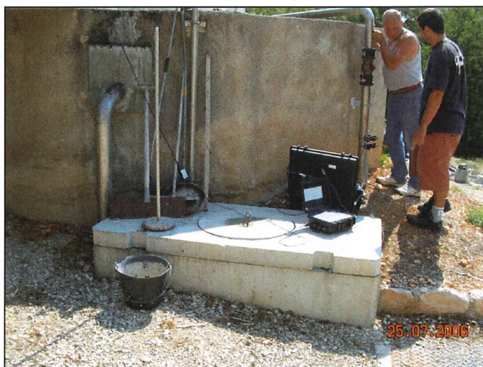
Photo 5 : Cuve de stockage des graisses
