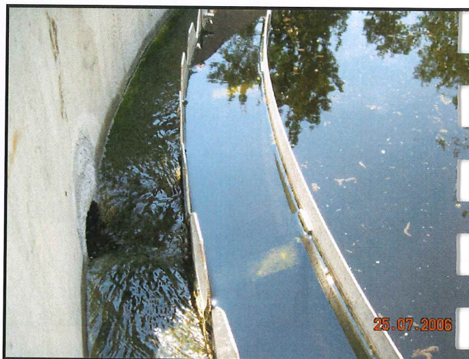
Photo 9 : Sortie du clarificateur
