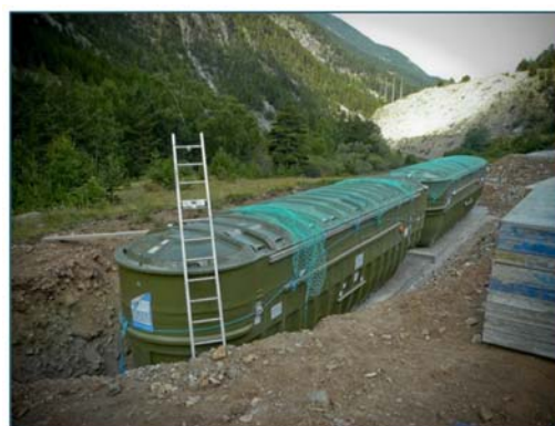
Les cuves de la STEP
