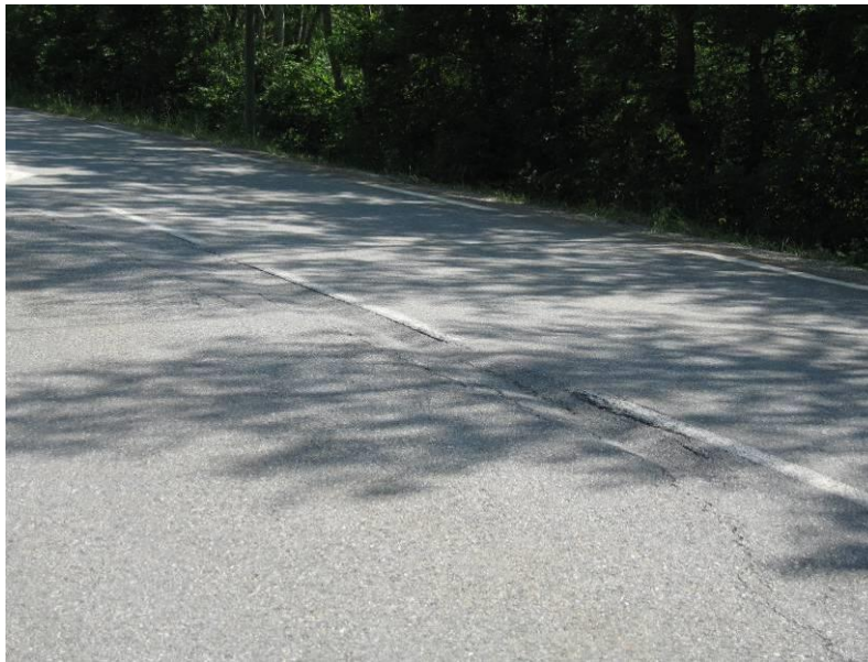
RN85 déformée – Vue au niveau de la Trinité
