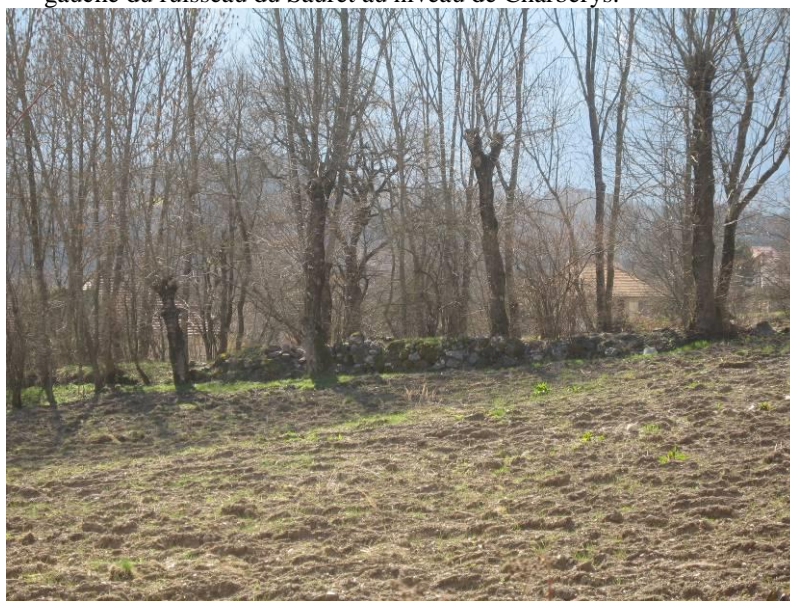
Merlon de terre en rive gauche du ruisseau du Sauret à Charberys – pas en très bon état
