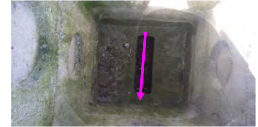
Regard pluvial Aval
