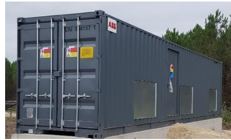
Exemple de Poste de transformation
