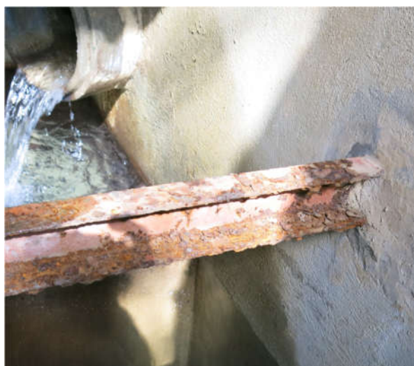
Détail des équipements - corrosion avancée (poutrelle IPN inutilisée)
