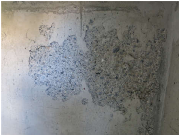
Vue de la maçonnerie intérieure : ragréage léger à prévoir
