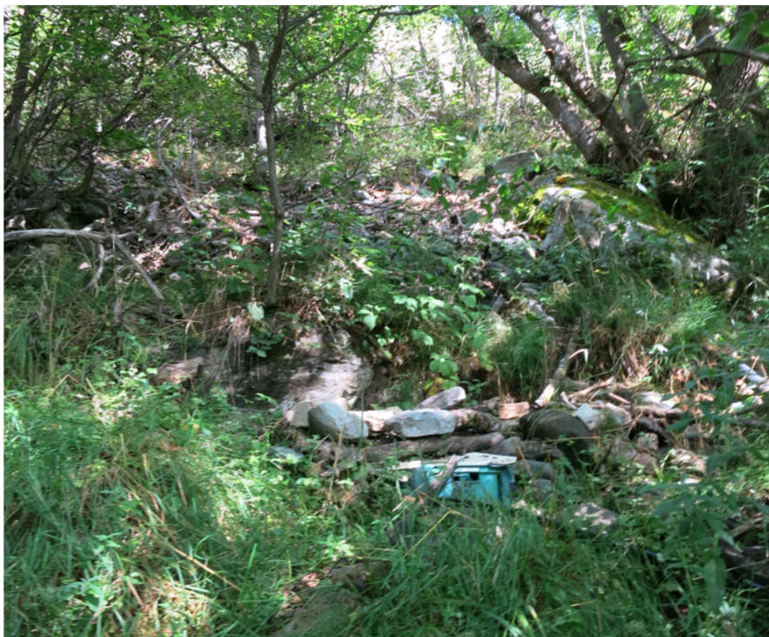
Vue d'ensemble de l'ouvrage en septembre 2016 (le captage a été repris depuis)
