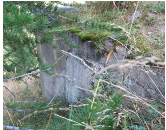
Vue de la maçonnerie extérieure : ragréage à prévoir
