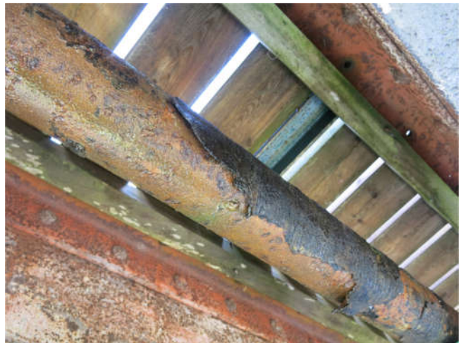
Détail de la canalisation sur son passage en encorbellement de la passerelle – corrosion avancée
