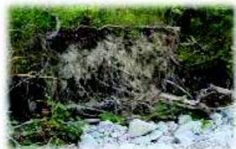
PHOTO 28 - LES BERGES ÉRODÉES
