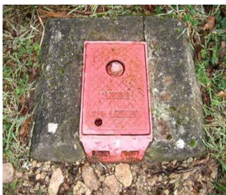
Bouche de lavage fermée
