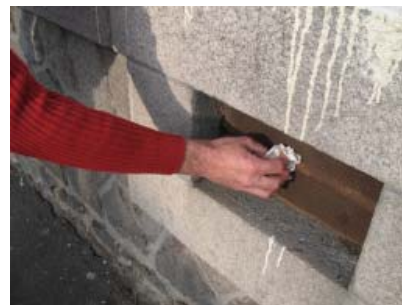
entretien d'entrée d'air du vide sanitaire
