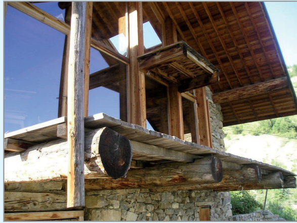
Les Aujards : rénovation conciliant balcon traditionnel (reposant sur les poutres du plancher) et ouvertures modernes (baies vitrées).
