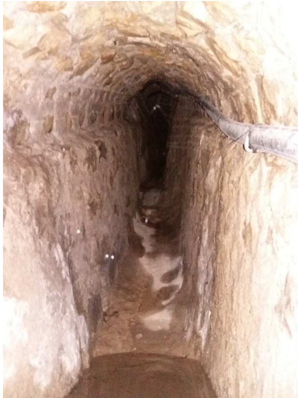
photo 2 : captage de Verdun vue intérieure
