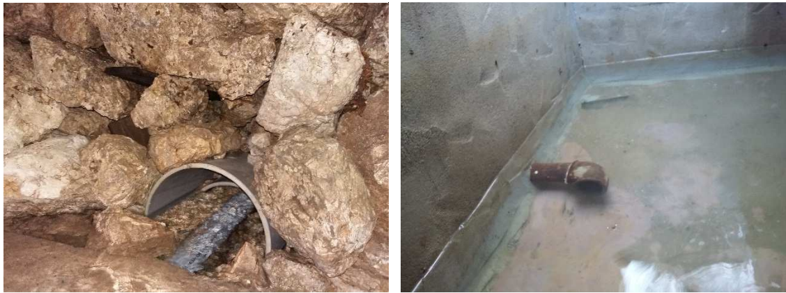
photo 4: captage de la Doue vues intérieures
