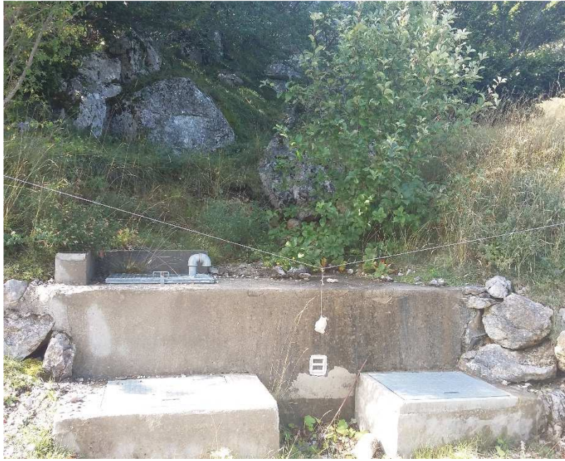
photo 3 : captage de la Doue vue extérieure
