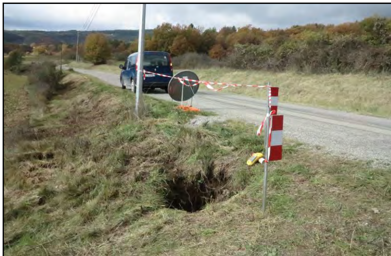
Figure 11 : Fontis apparu en novembre 2014 au bord de la RD16 sur la commune de Sigonce
