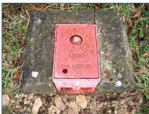
Bouche de lavage fermée
