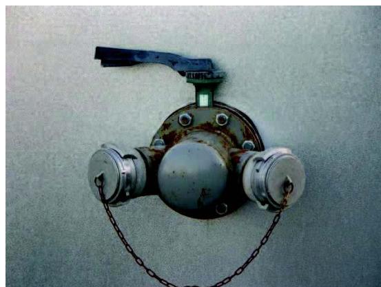
Prises directes de 100 mm sur réservoir aérien
