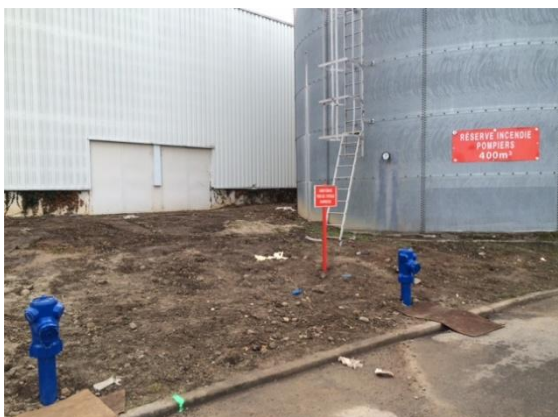
Réservoir aérien de 400 m 3 avec poteaux d'aspiration
