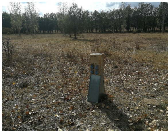
Repérage des points de raccordement électrique
