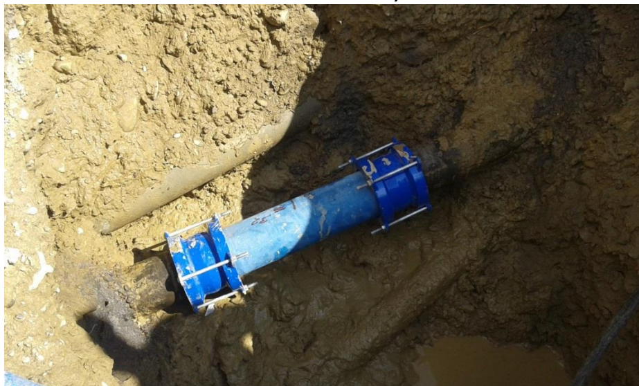
Oraison – Août 2016 Fuite sur canalisation Ø 150
