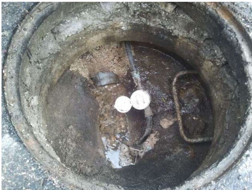
Figure 3 : Branchement d'eau potable dans le regard 45 à l'intersection de la rue Olérys et Frédéric Mistral
