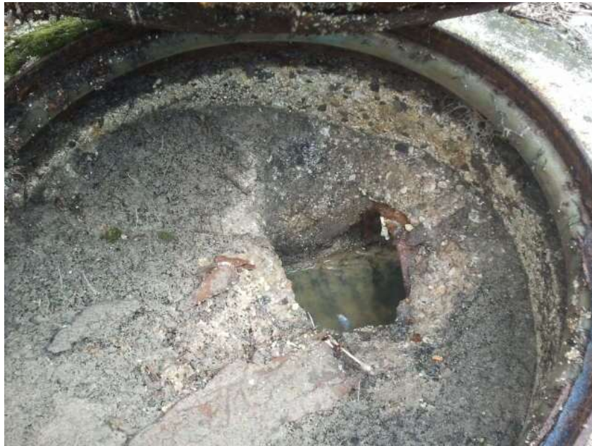
Figure 2 : Traces de mise en charge sur le regard 57, 700m en amont de la STEP
