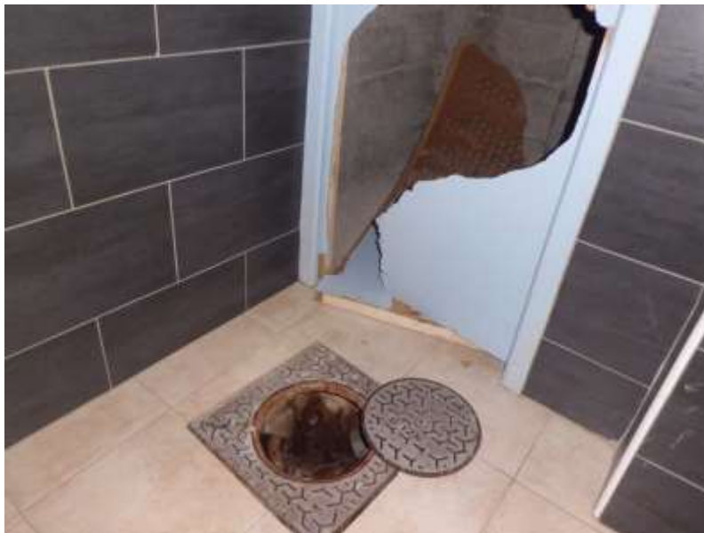
Figure 9 : Arrivée d'eau claire dans le regard des WC publics
