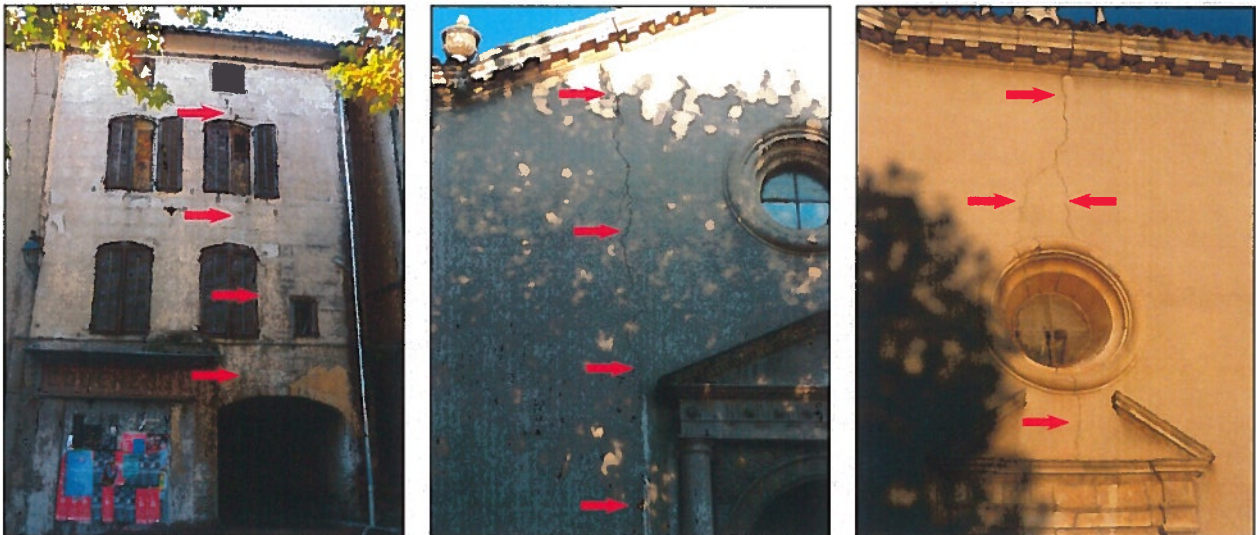
Figure 13 : Fissures sur des constructions (centre du village) [Source : IMS RN ]
