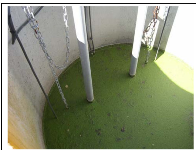
Photo 6 : Poste de recirculation
