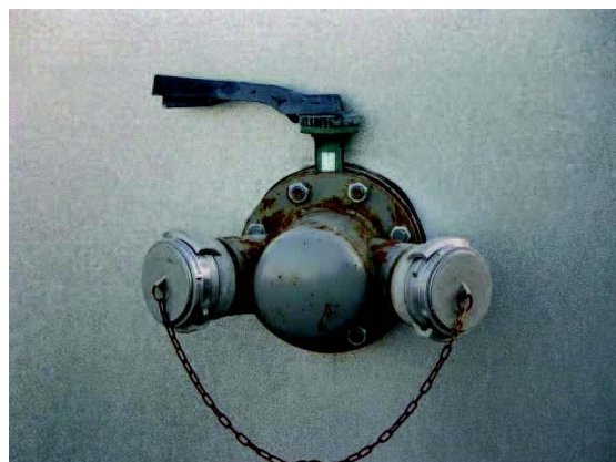
Prises directes de 100 mm sur réservoir aérien
