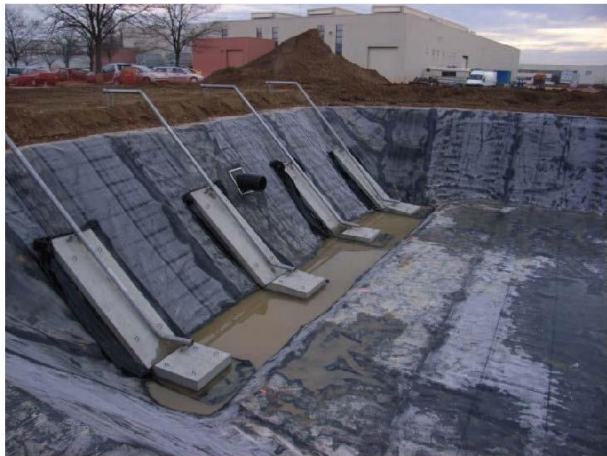
Réserve incendie 1500 m 3
