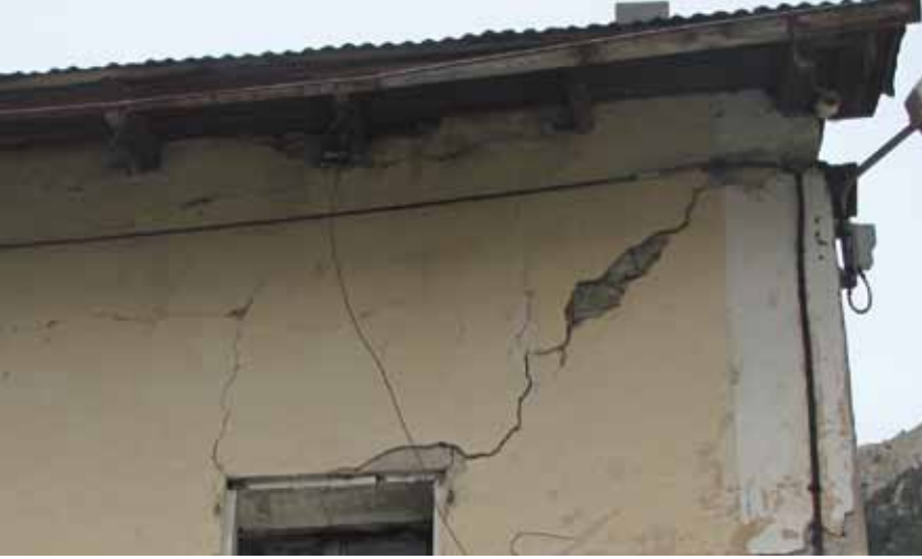
Dommages sur bâtiment ancien hameau des Gleisolles
