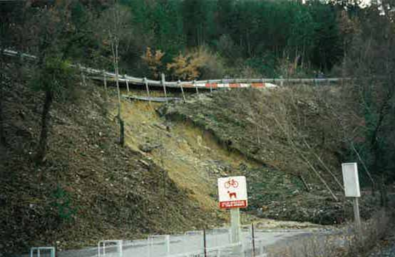
Glissement de terrain Digne les Bains
