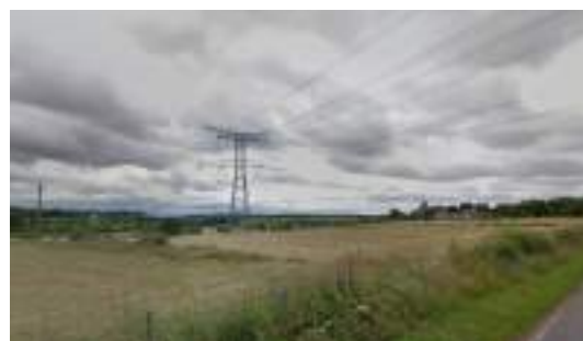
Lignes de 400 kv
