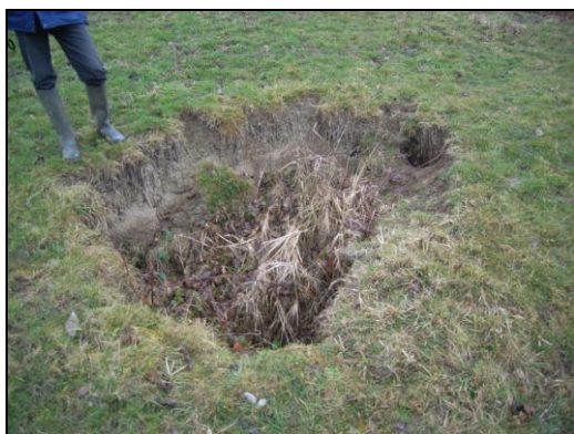
Photo 3 : Désordre F4 situé sur le quartier Bois Girard (Photo INERIS)
