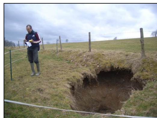
Photo 4 : Désordre F5 situé sur le quartier Saint Claude (Photo INERIS)
