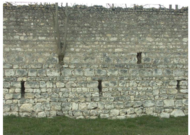
Un soutènement avec ses barbicanes ; la présence de végétation endommage les murs et les mène à la ruine.
