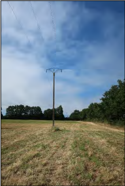
Ligne électrique passant par l'Ouest du site, vue Nord-Ouest du site d'étude
