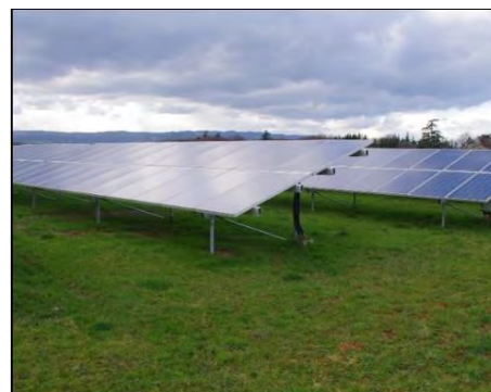
Reprise végétale sous les panneaux photovoltaïques
