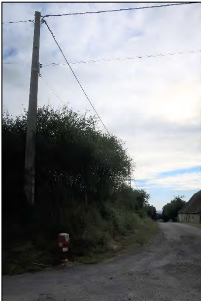
Ligne téléphonique longeant le Sud du site, vue Sud-Ouest du site d'étude
