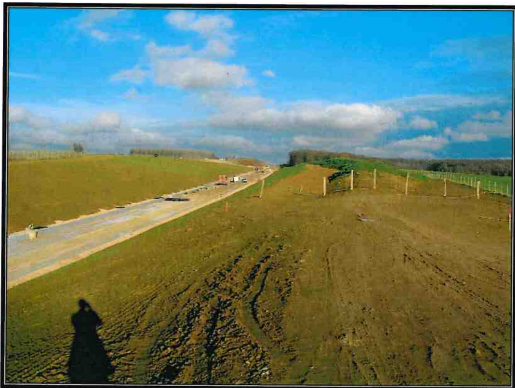
Passage limite Nord de la Commune de la LGV Est en cours de construction
