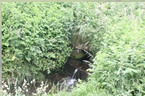
Un lavoir en pierre bleue à restaurer
