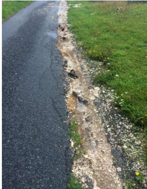
Figure 68 : Érosion d'accotements suite à des écoulements torrentiels
