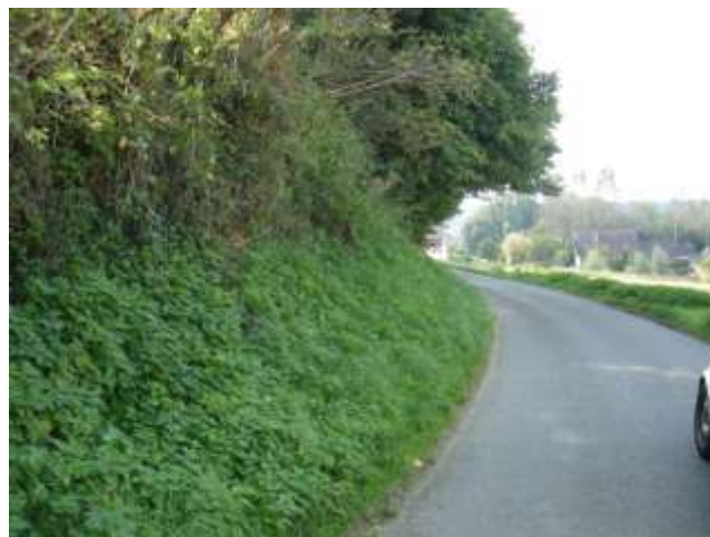
Glissement de terrain route départementale La Vallée
