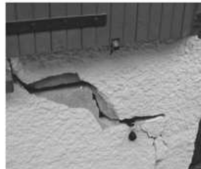
Maison fissurée dans le Pas-de-Calais, août 2003. Sources : BRGM - P. Barthe
