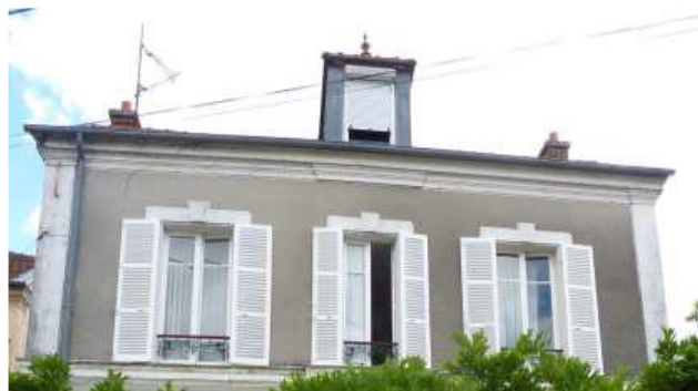
Le caisson du volet roulant alourdit complètement la lucarne.
