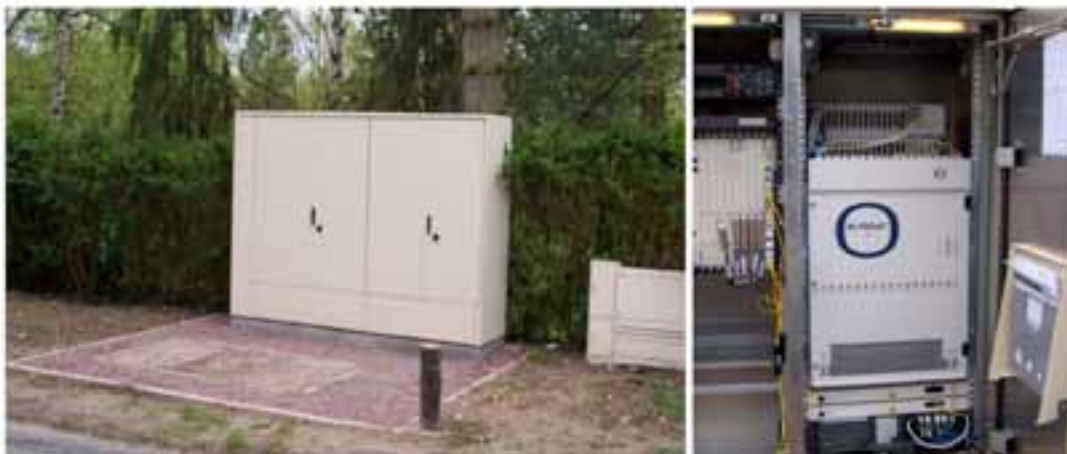
Photo d'une armoire de montée en débit (avec DSLAM opérateur)
