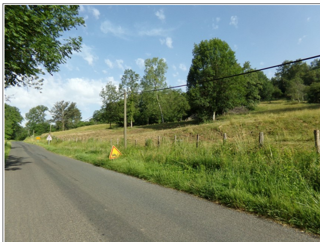
Figure III.59: fluage 200 mètre à l'ouest du hameau de Bublanne à l'amont de la RD 93a (proximité du cimetière).
