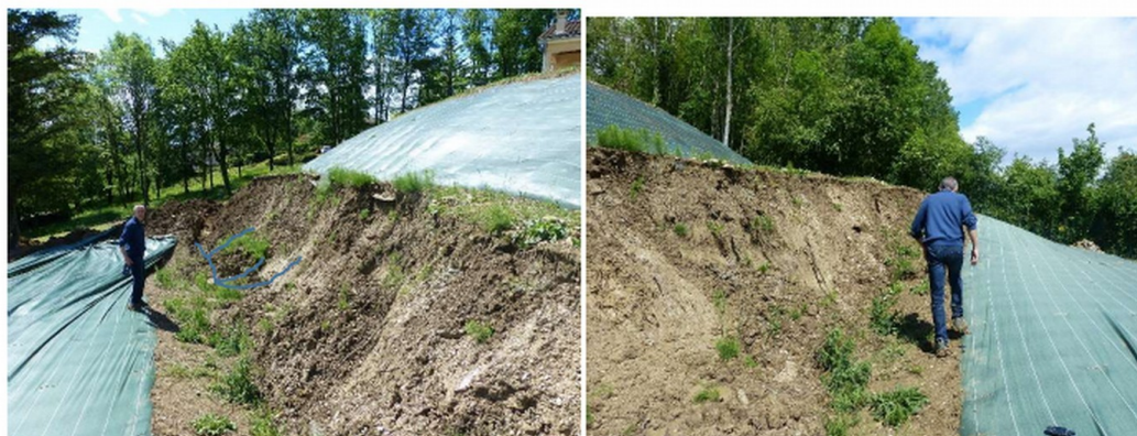
FIGURE 5 : TÊTE DU GLISSEMENT (SOURCES SUINTANT DANS LA PARTIE BASSE DE L'ESCARPEMENT)
