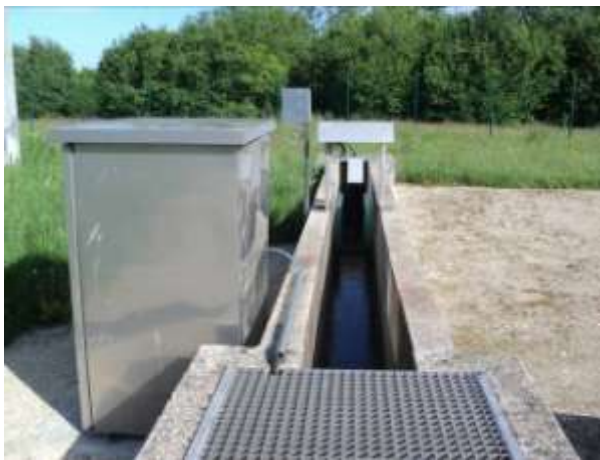
Canal de mesures de type Venturi
