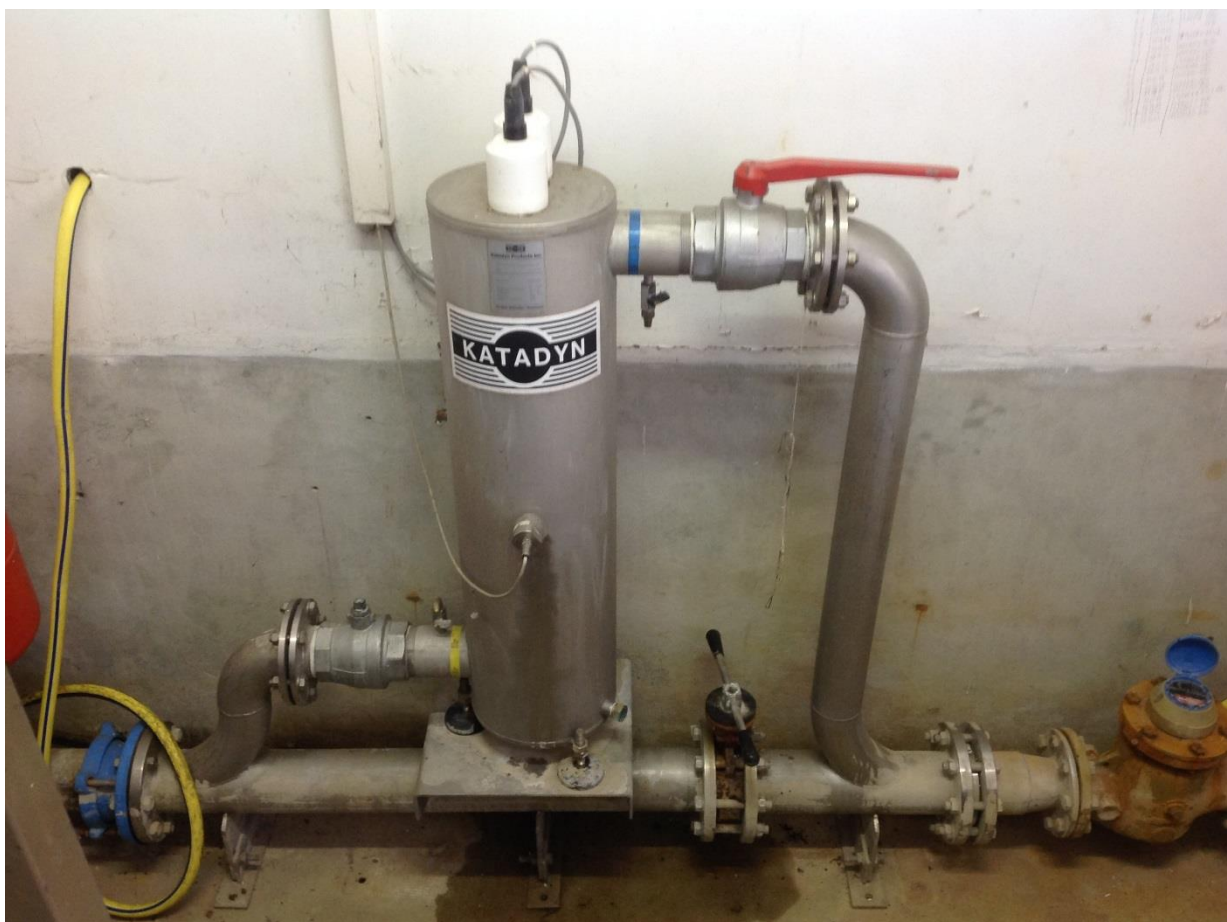
Photo 4 – Equipement de Traitement aux UV installé au puits de pompage
