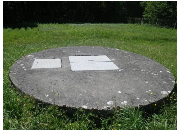
Dalle du puits avec à gauche la trappe de descente, et à droite la trappe d'accès aux pompes
