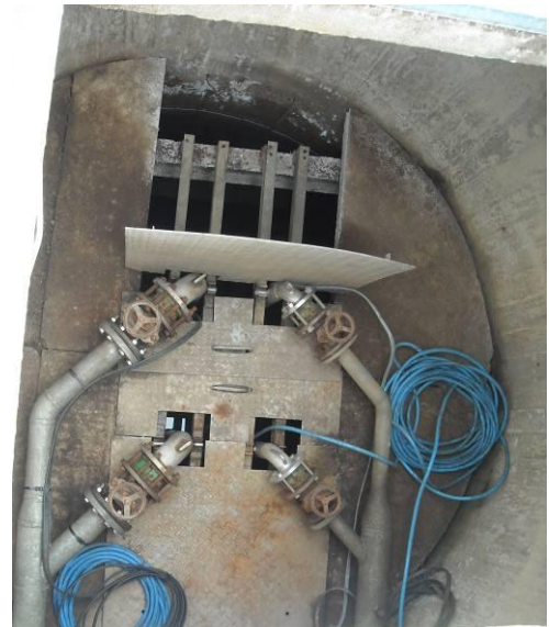
A droite les pompes desservant TALISSIEU et à gauche les pompes desservant BEON
