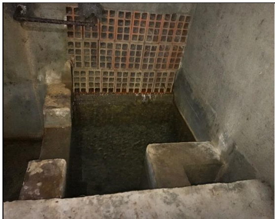
La source percole au travers des briques Perforées et remplissent un premier bac de décantation
