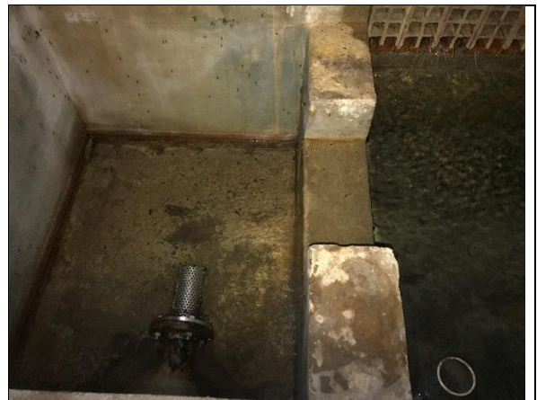
Vue du second bac et du départ vers le réservoir par le tuyau équipé d'une crépine
