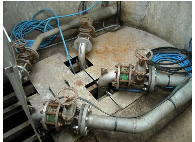
plateforme d'accès aux pompes à l'intérieur du puits
