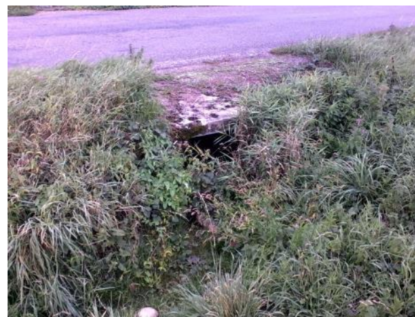
Encombrement de l'ouvrage aval
