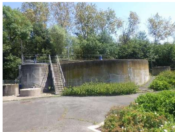
Bassin d'aération – STEU Chef-lieu
