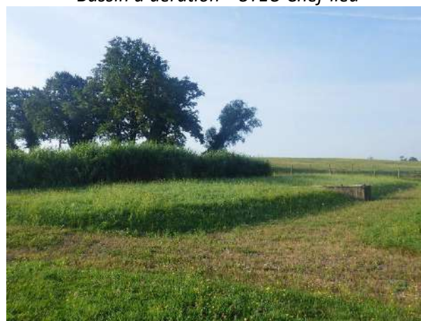
2 ème étage – Filtre planté de roseaux STEU Vial
