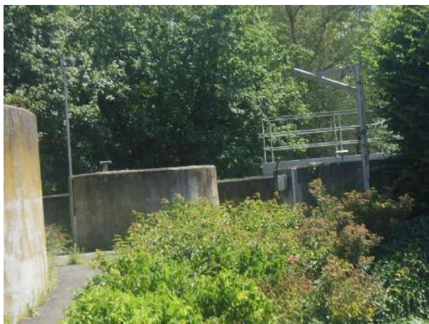
Poste de refoulement – Entrée STEU Chef-lieu
