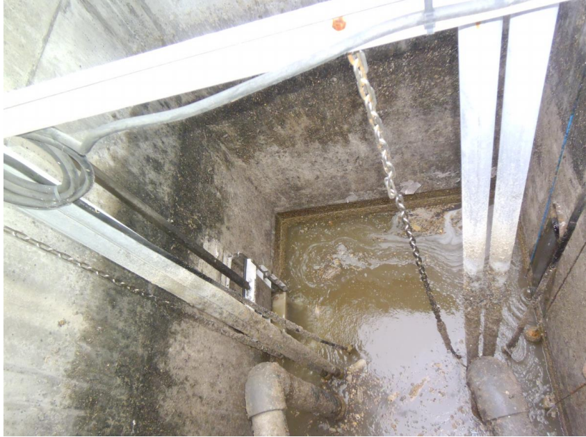
Figure 12 : Poste de relevage
