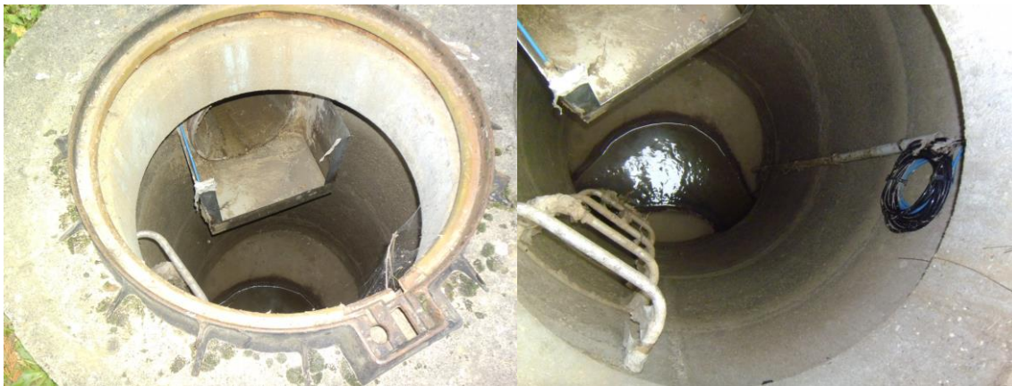
Figure 11 : Déversoir d'orage situé en amont du poste de relevage
