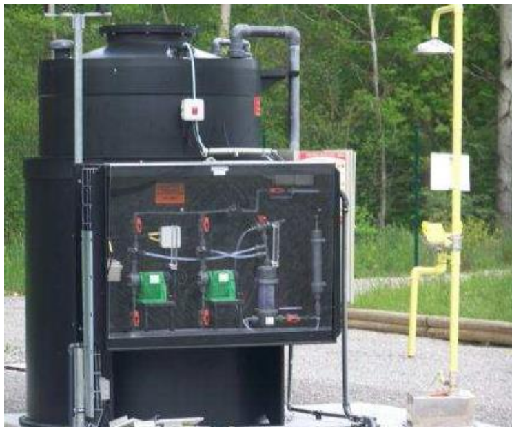
Figure 32 : Cuve de chlorure ferrique et douche de sécurité
