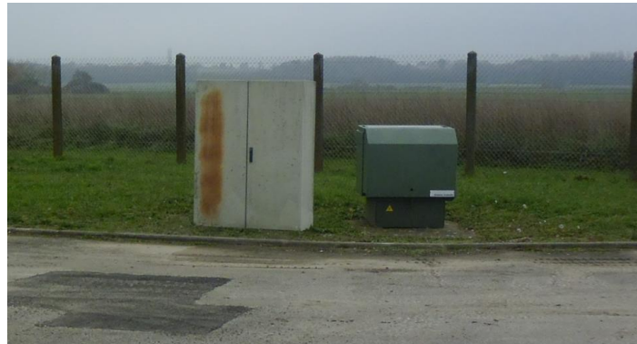
Figure 23 : Interrupteur général et transformateur
