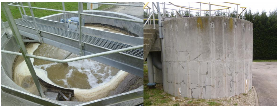
Figure 14 : Ouvrage de dessablage/déshuilage
