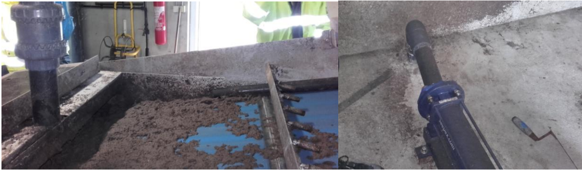
Figure 21 : Table d'égouttage et pompe gaveuse d'alimentation du silo à boues
