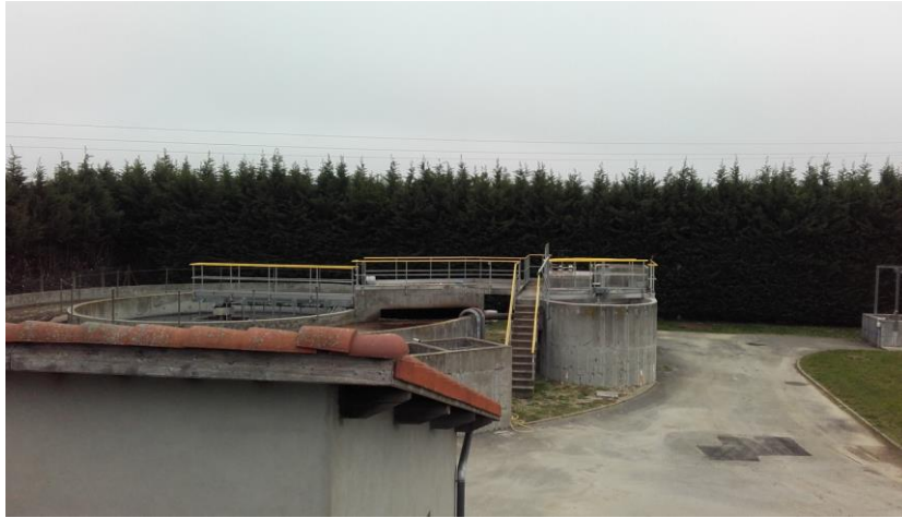
Figure 4 : Station d'épuration de Mionnay
