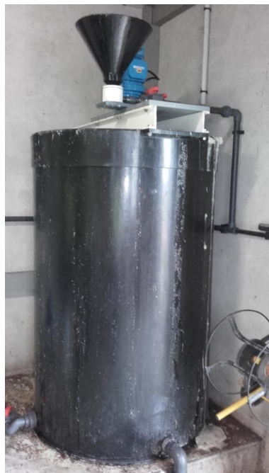
Figure 20 : Bac de préparation de polymère
