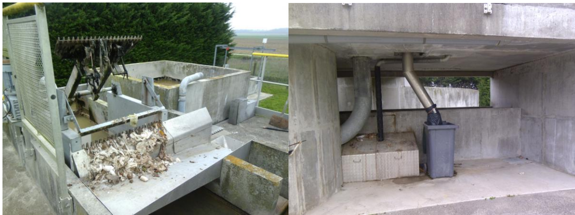
Figure 13 : Dégrilleur grossier automatique
