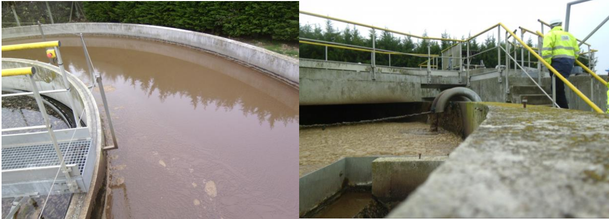
Figure 16 : Bassin d'aération en chenal à pont brosse
