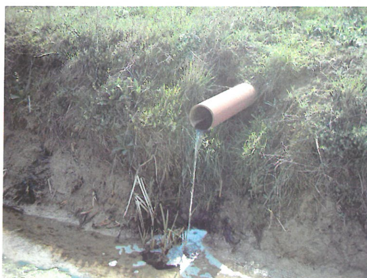
Photo 3 : Rejet des effluents traités en sortie de lagune.
