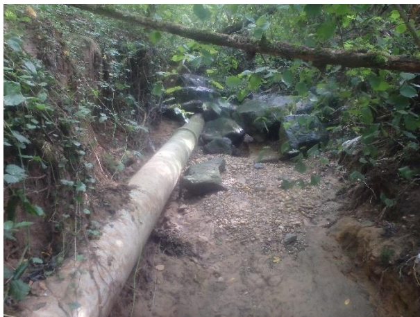
Collecteur implanté entre Jassans-Riottier et Frans mis à nu suite à des crues
