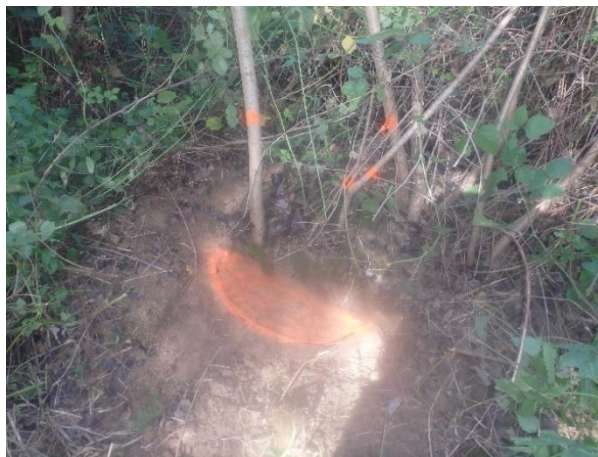
Tampon d'accès à un regard enterré et pris dans les racines
