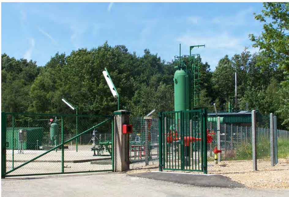
Isolés aussi et disséminés sur le territoire, des stations et puits de stockage de gaz souterrain (ici, le puits EZ 07 près de Guignebois)
