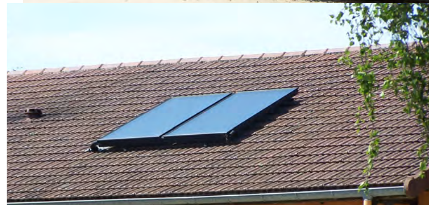
Les toits se parent de panneaux solaires ou photovoltaïques (ci-dessus).
