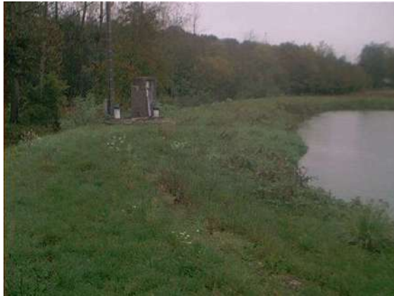
Photo 7 : Poste de relevage
