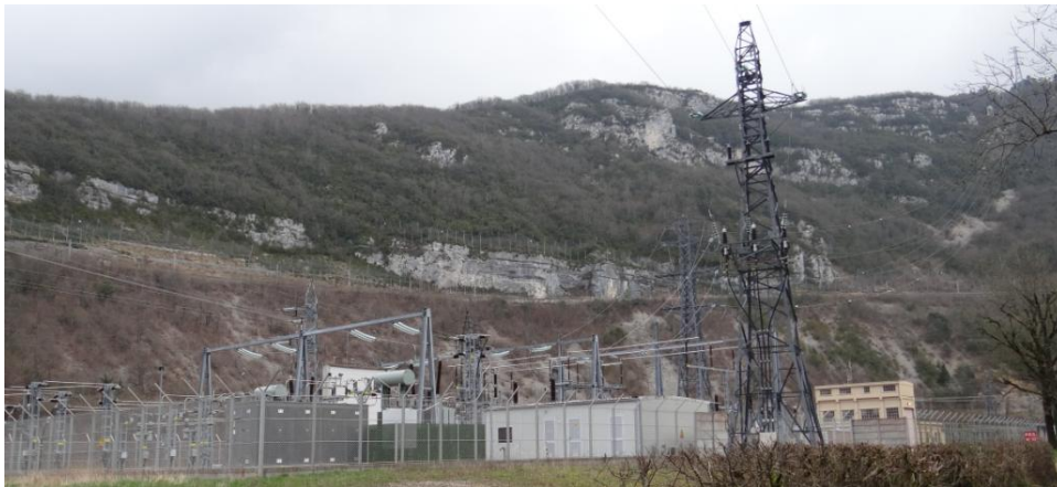
Le poste d'interconnexion de la société RTE – BLC 2015
