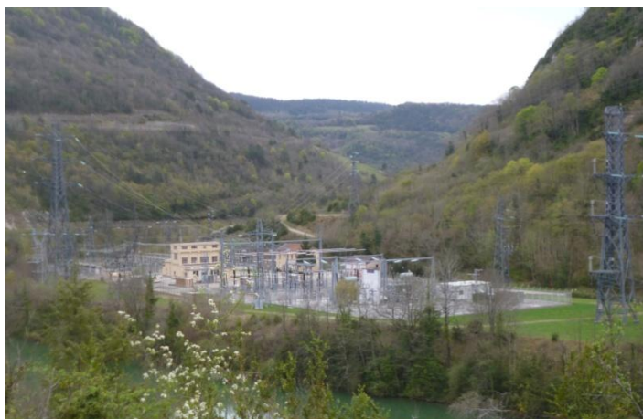
Le poste d'interconnexion électrique de Cize – BLC 2015
