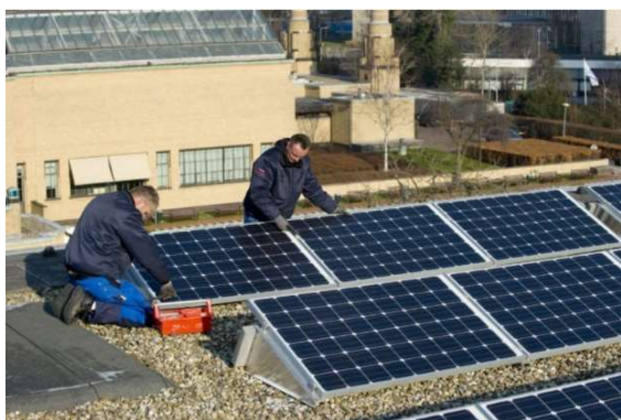
Exemple de fonction sur des toitures terrasses - Source : https://blog.eneco.be/
