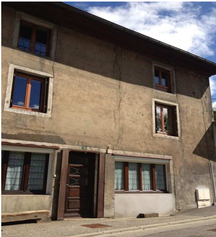
Fig.8, Habitation fissurée sur la Grande rue.
