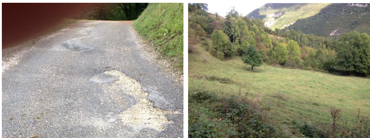
Fig.6, A gauche, désordres sur la route de Plomb. A droite, terrains boursoufflés vers le Mortier
